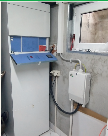
So bauen die Schweden die Wärmepumpe seit Jahrzehnten ein: Eine Ecke im Hauswirtschaftsraum reicht. ©Gerhard Roland
